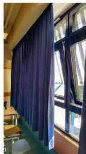
IL SISTEMA AUTOMATICO di apertura/chiusura delle finestre con logica basata sulla CO 2 ; anche questo dispositivo contribuisce al significativo miglioramento della IAQ
