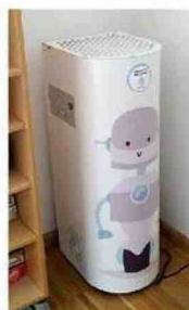
L'IMPIEGO di depuratori dell'aria di tipo attivo (nella foto un esempio) non hanno sortito effetti positivi sulla IAQ all'interno delle aule
