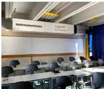
L'IMPIANTO VMC decentralizzato installato in una delle aule: il ricambio igienico dell'aria permette una sostanziale riduzione della CO 2 e degli inquinanti
